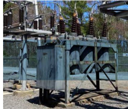
G7 69kV OCB
